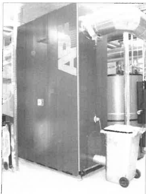
Slika 10: Primer elektrostatičnega filtra v kotlovnici
